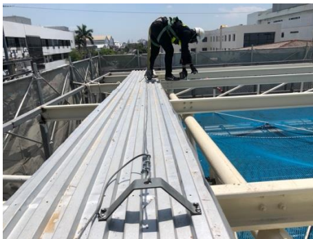
ภาพที่ 21 การนำระบบขั้วยั้งการตกส่วนบุคคลหลังการปรับปรุงไปใช้งาน
