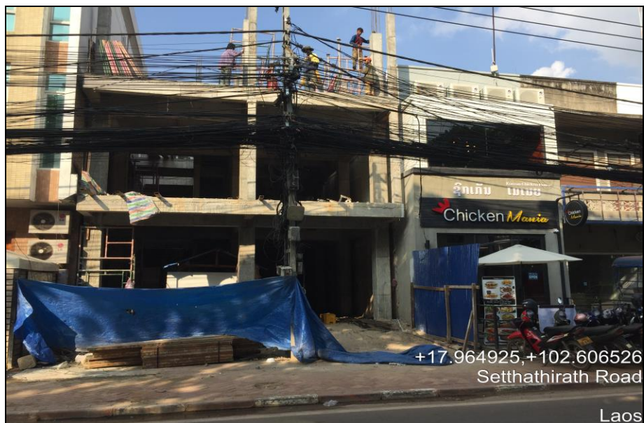
ภาพที่ 4-9 ปัญหาสำคัญเร่งด่วนที่มีความเสี่ยงต่อความปลอดภัยในชีวิตและทรัพย์สินของประชาชน ที่ได้สำรวจพบในเขตพื้นที่ของโครงการที่มีการติดตั้งสายสื่อสารพาดผ่านบริเวณที่กำลังมีการก่อสร้างอาคารที่ข้างร้านซิกเก้น มาเนีย (Chicken Mania)
