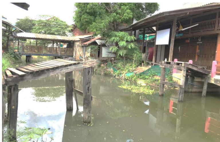
ภาพที่ 4-68 สะพานหกข้ามคลองท่าตะกูในปัจจุบัน พื้นไม้ที่ยกได้เสียหายทั้งหมด
