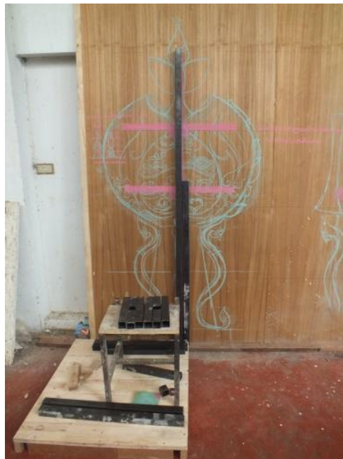
ภาพที่ ๓-๓๘ ขั้นตอนที่ ๒ การเชื่อมโครงเหล็กตามแบบร่าง
