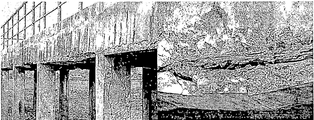
รูปที่ 2.1 ลักษณะการกัดกร่อนของโครงสร้างคอนกรีตเสริมเหล็กในสภาวะแวดล้อมทะเล
