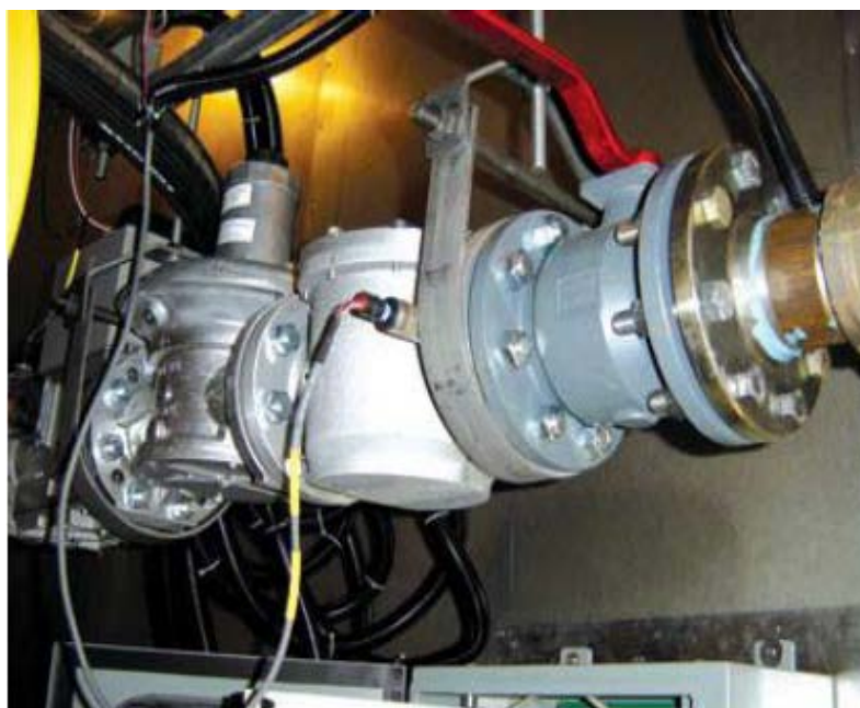
ภาพที่ 3-12 อุปกรณ์ชุด Gas train ของเครื่องยนต์ก๊าซชีวภาพ (สำนักเทคโนโลยีความปลอดภัย กรมโรงงานอุตสาหกรรม กระทรวงอุตสาหกรรม, 2553)
