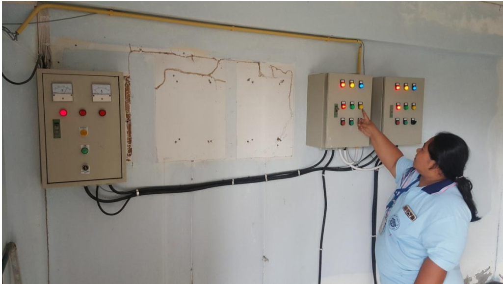
ภาพที่ 4-4 ตู้ควบคุมชำระ หมู่ที่ 1
