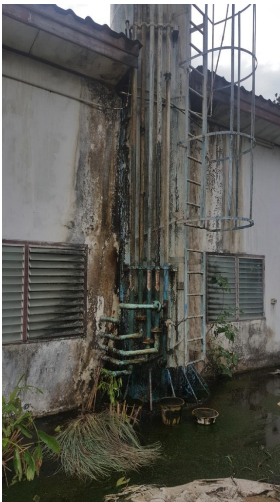
ภาพที่ 4-9 หอถังสูงชำรุด หมู่ที่ 6
