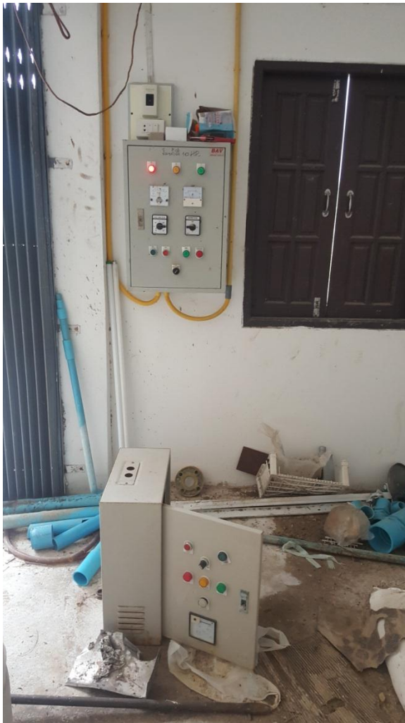
ภาพที่ 4-8 ตู้ควบคุมไฟฟ้าชำรุด หมู่ที่ 3
