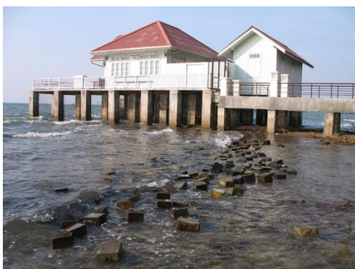
(ก) คอนกรีตในสภาพเปื่อยก
