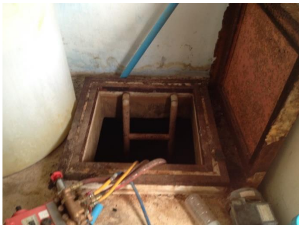
ภาพภาคผนวกที่ ข-46 ถังน้ำใส ขนาด 27 ลูกบาศก์เมตร
