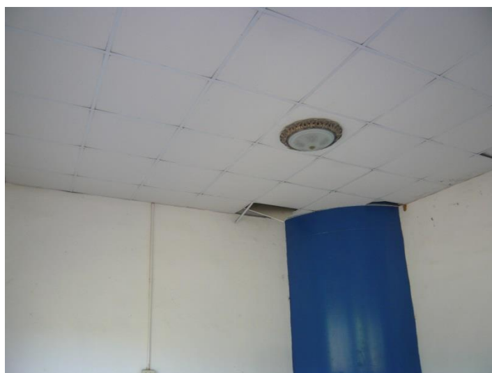
ภาพภาคผนวกที่ ข-5 ฝ้าเพดานภายในอาคารควบคุมการผลิตน้ำประปาชำรุด
