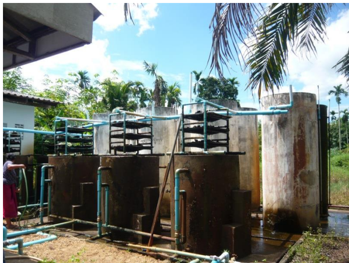
ภาพภาคผนวกที่ ข-44 ระบบตกตะกอนและชุดถังกรองน้ำฝิวดิน ขนาด 3 ลูกบาศก์เมตร/ ชั่วโมง
