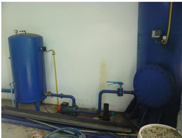
ภาพภาคผนวกที่ ข-25 เครื่องสูบน้ำจ่ายน้ำดีและถังแรงดัน ขนาด 500 ลิตร/ นาที
