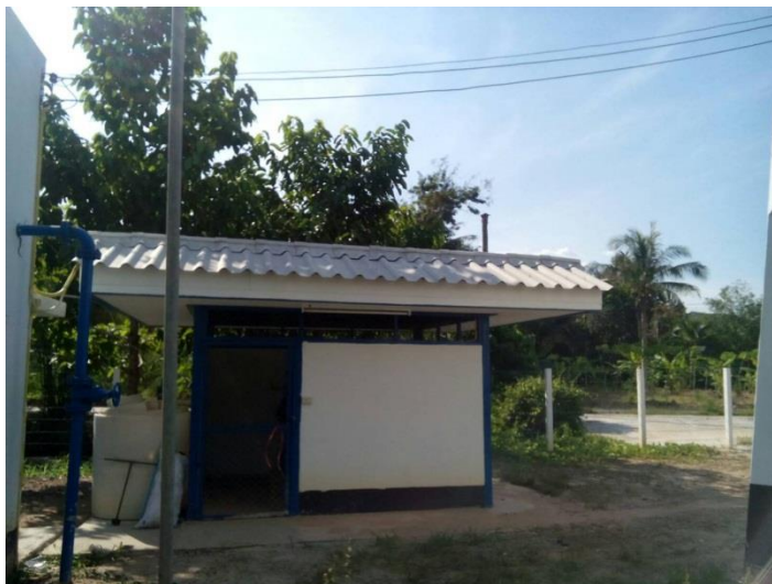
ภาพภาคผนวกที่ ข-78 โรงสูบน้ำดิบ
