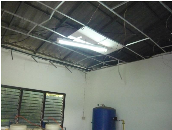
ภาพภาคผนวกที่ ข-20 ฝ้าเพดานภายในอาคารผลิตน้ำประปาชำรุด
