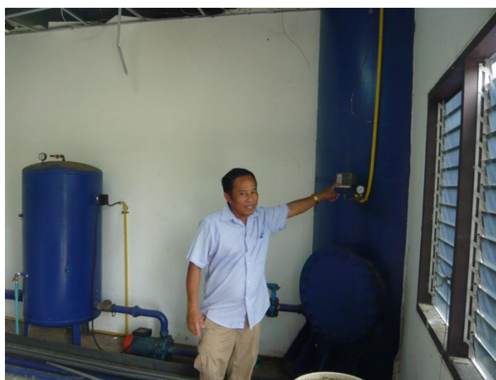
ภาพภาคผนวกที่ ข-21 ถังกรองน้ำบาดาล ขนาด 10 ลูกบาศก์เมตร/ ชั่วโมง และเก็บน้ำ
