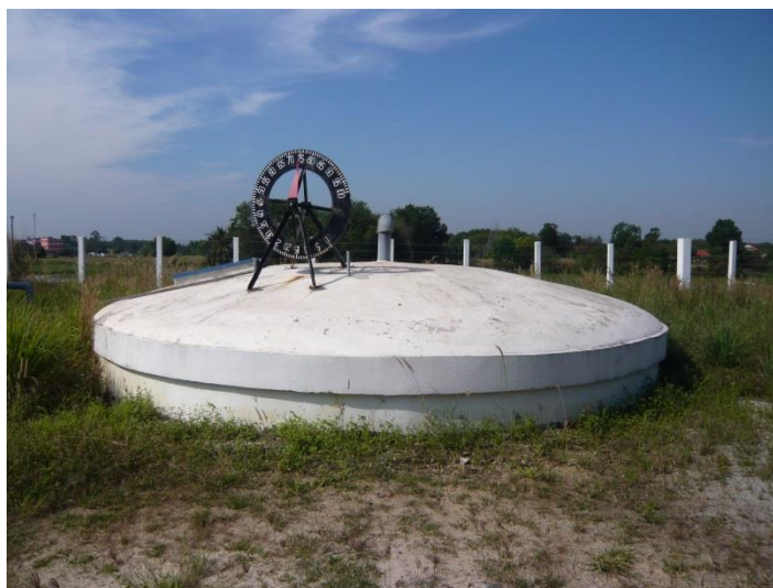
ภาพภาคผนวกที่ ข-105 ถังน้ำใส ขนาด 100 ลูกบาศก์เมตร
