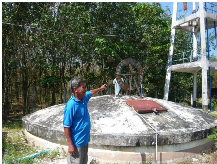
ภาพภาคผนวกที่ ข-94 ถังน้ำใส ขนาด 100 ลูกบาศก์เมตร
