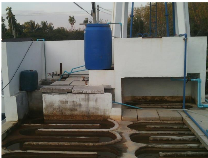
ภาพภาคผนวกที่ ข-79 ถังจ่ายสารละลายสารส้มและคลอรีน
