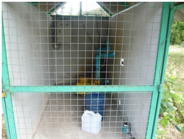
ภาพภาคผนวกที่ ข-42 โรงสูบน้ำดิบ
