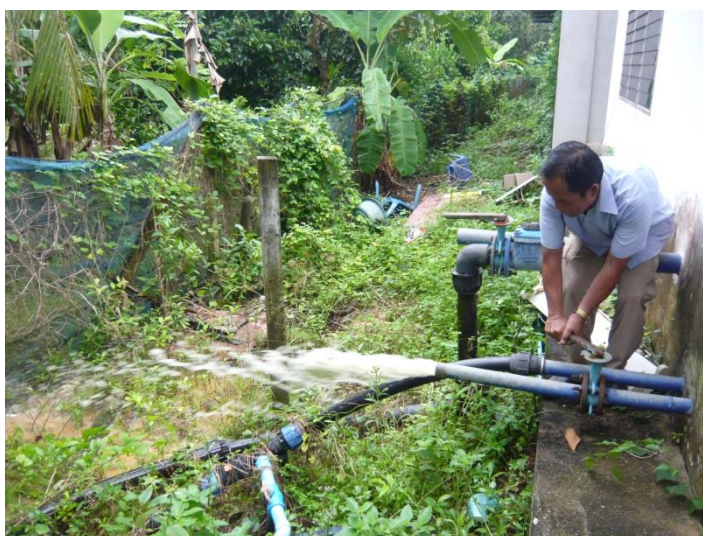
ภาพภาคผนวกที่ ข-23 ท่อล้างย้อนถึงกรองและระบายตะกอน
