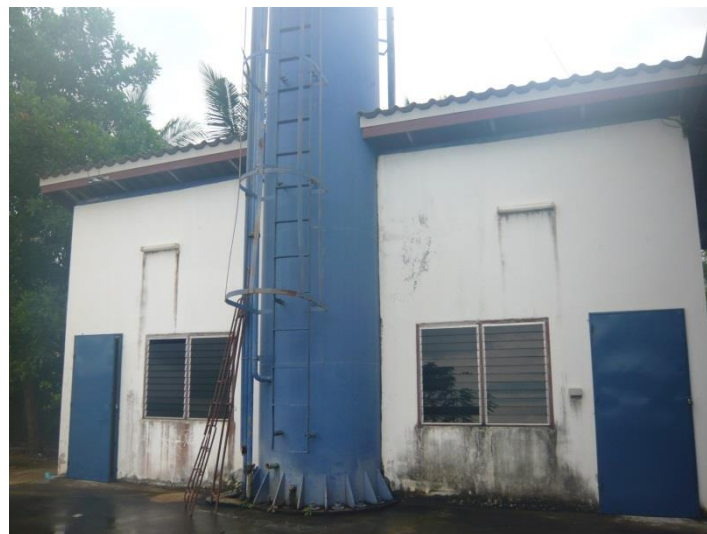
ภาพภาคผนวกที่ ข-19 อาคารควบคุมการผลิตน้ำประปาหมู่บ้าน บ้านห้วยหิน
