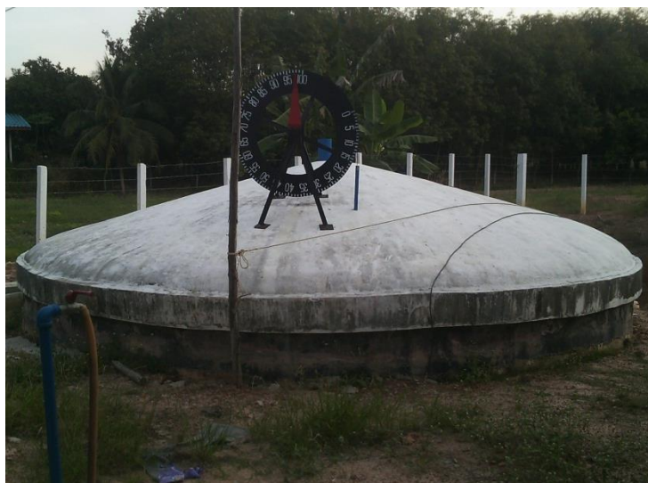
ภาพภาคผนวกที่ ข-81 ถังน้ำใส ขนาด 100 ลูกบาศก์เมตร
