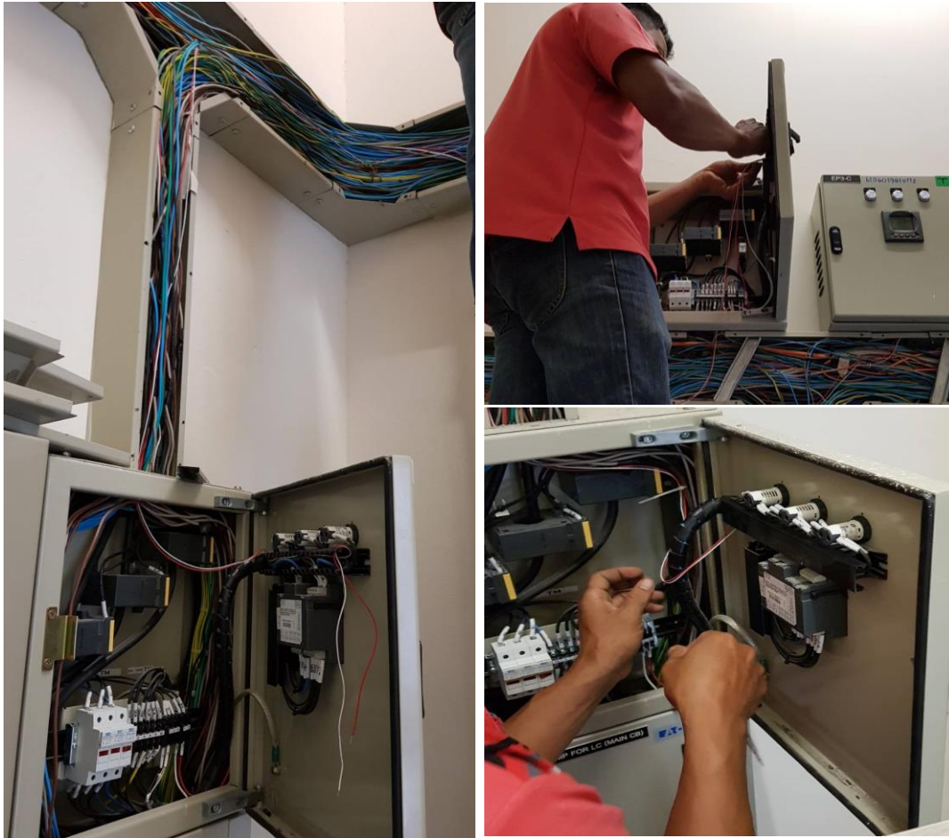
ภาพที่ 3 - 35 แสดงการติดตั้งอุปกรณ์ภายในห้องไฟฟ้าภายในตู้ไฟฟ้าในแต่ละชั้น
