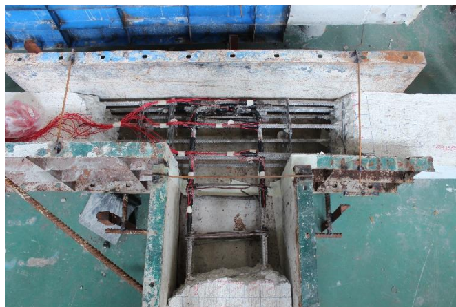
รูปที่ 3.7 สภาพตัวอย่างหลังจากสกัดคอนกรีตที่เสียหาย
