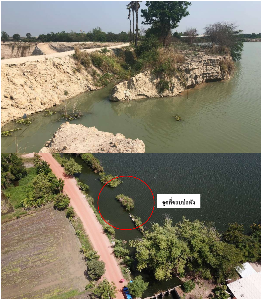
ภาพที่ 4- 83 (บน) ลักษณะทางกายภาพของบ่อ BB1 ซึ่งดินขอบบ่อทรุดพังทำให้พื้นที่บ่อเชื่อมกับคลองขายน้อย (ล่าง) ภาพจากอากาศยานไร้คนขับ (UAV) แสดงให้เห็นขอบบ่อบริเวณที่พังทำให้น้ำในคลองหนองมะเชื้อถ่ายเทเข้าสู่บ่อ BB2
