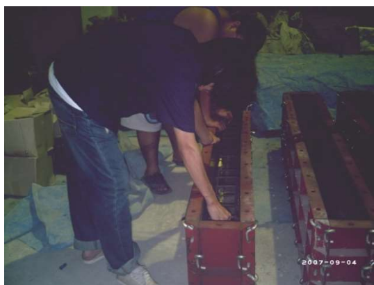
ภาพที่ 3.29 การนำคานตัวอย่างที่ประกอบเสร็จใส่ลงในแบบหล่อคานทดสอบ
