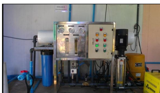
เครื่องกรอง Reverse Osmosis (R.O.)
