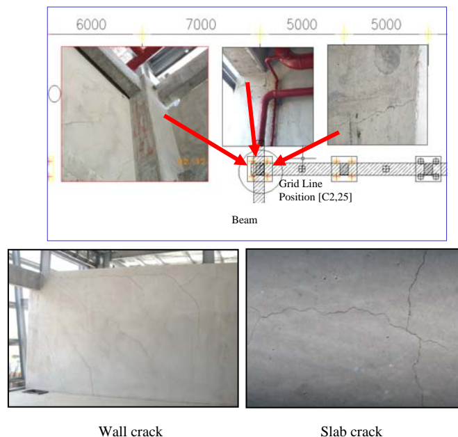
รูปที่ 1-3 ความเสียหายต่อโครงสร้าง
