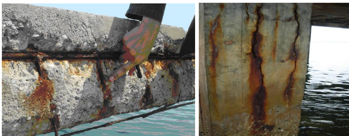
รูปที่ 2.2 ความเสียหายของคอนกรีตเสริมเหล็กเนื่องจากคลอไรด์
