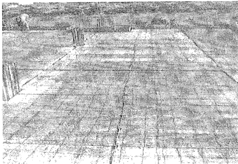
รูปที่ 2.10 การใช้แผ่นพื้นสำเร็จท้องเรียบ (Plank Slab) ในงานก่อสร้างอาคารในประเทศไทย
