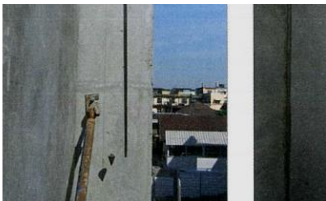
ภาพที่ 2-13 ประกอบติดตั้งชิ้นส่วน โครงสร้างให้ตั้งตรงได้ดิ่ง โดยการตั้งดิ่ง (เทอดธรรม ยอดพฤติกกรม์, 2555)
