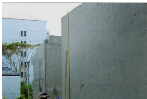
ภาพที่ 2-100 การตรวจสอบแนวระดับผนัง (เทอดธรรม ยอดพฤติการณ์, 2555)
