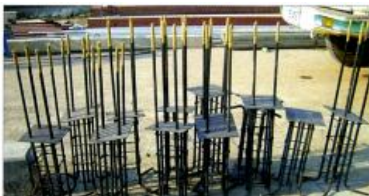
ภาพที่ 2-31 รายละเอียดการจัดตำแหน่ง Dowel เสา ด้วยแผ่นเจาะรู (เทอดธรรม ยอดพฤติกัรณั, 2555)
