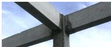
ภาพที่ 2-57 รอยต่อคานที่มีการจี้คอนกรีต (เทอดธรรม ยอดพฤติกัณณ์, 2555)
