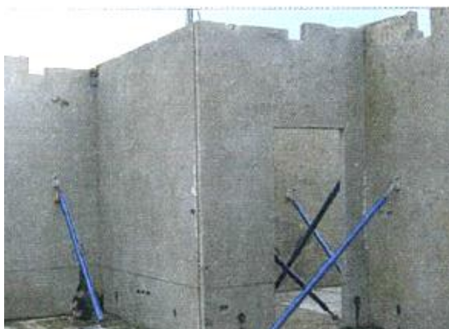
ภาพที่ 2-14 ประกอบติดตั้งชิ้นส่วน โครงสร้างให้ได้ระยะในแนวดิ่ง โดยตรวจสอบกับเส้นระดับ (เทอดธรรม ยอดพฤติกกรม์, 2555)
