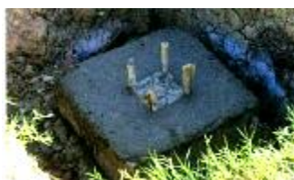
ภาพที่ 2-33 ฐานรากที่เทคอนกรีตเรียบร้อยแล้ว (เทอดธรรม ยอดพฤติกัรณ, 2555)
