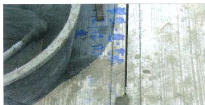
ภาพที่ 2-101 การตีเส้นแนวผนังบนพื้น (เทอดธรรม ยอดพฤติการณ์, 2555)
