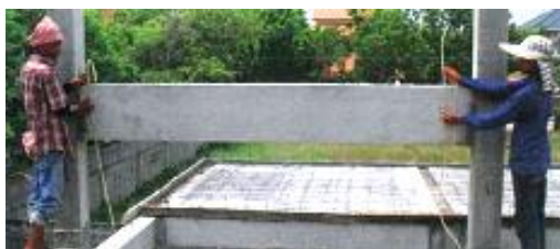
ภาพที่ 2-48 การใช้ระดับน้ำตรวจสอบระดับคาน (เทอดธรรม ยอดพฤติกัณณ์, 2555)
