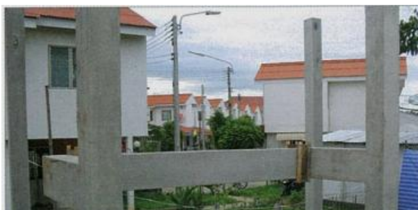
ภาพที่ 2-87 หลังคานที่มีความเรียบร้อยพร้อมทำการติดตั้ง (เทอดธรรม ยอดพฤติกการณ์, 2555)
