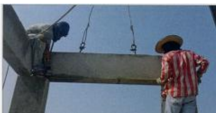
ภาพที่ 2-47 การตรวจสอบระยะช่วงเสาที่จะติดตั้งคาน (เทอดธรรม ยอดพฤติกัณณ์, 2555)
