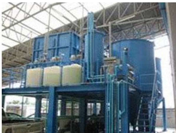
ภาพที่ 4-9 โรงบำบัดน้ำเสียในโรงงานก่อนปล่อยออกภายนอกโรงงาน
