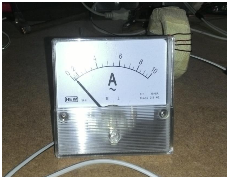
ภาพที่ 14 ค่ากระแสไฟฟ้าที่วัดจาก Current Transformer
