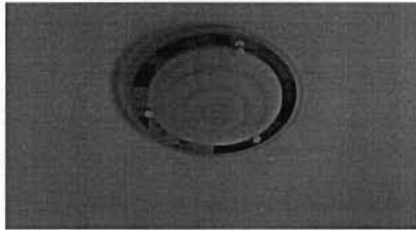
ภาพที่ 17 ตัวอย่างงานไฟฟ้าภายในบ้าน
