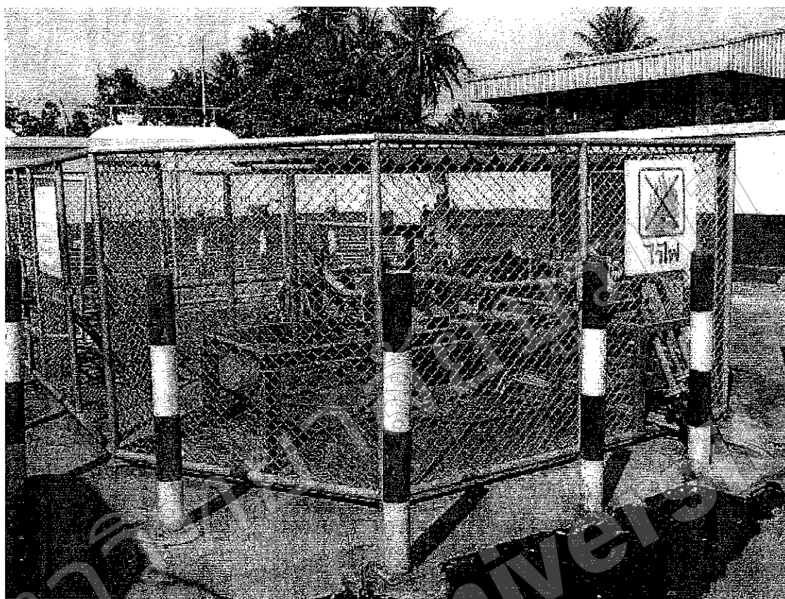
ภาพที่ 4-2 บริเวณถังบรรจุก๊าซ LPG ซึ่งเก็บอยู่ใต้ดิน
