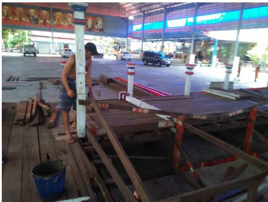
ภาพที่ 5-95 เริ่มติดตั้งเสาบริวาร (เสาเล็ก) ที่ชั้นสอง ใส่ประตอ ไม้รัดเสา ทำแบบเดียวกับชั้นแรกแต่ไม่ต้องวางฐาน
