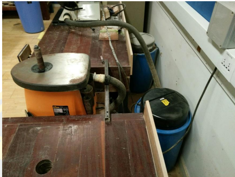
ภาพที่ 16 ระบบระบายฝุ่นไม้ที่มีอยู่เดิม
