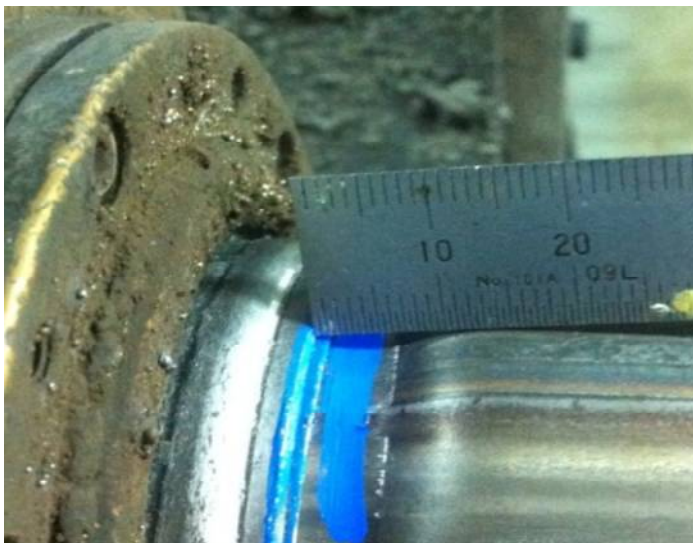
ภาพที่ 4-1 ระยะห่างของ Flex กับ Pipe ก่อนการปรับปรุง (7 มิลลิเมตร)
