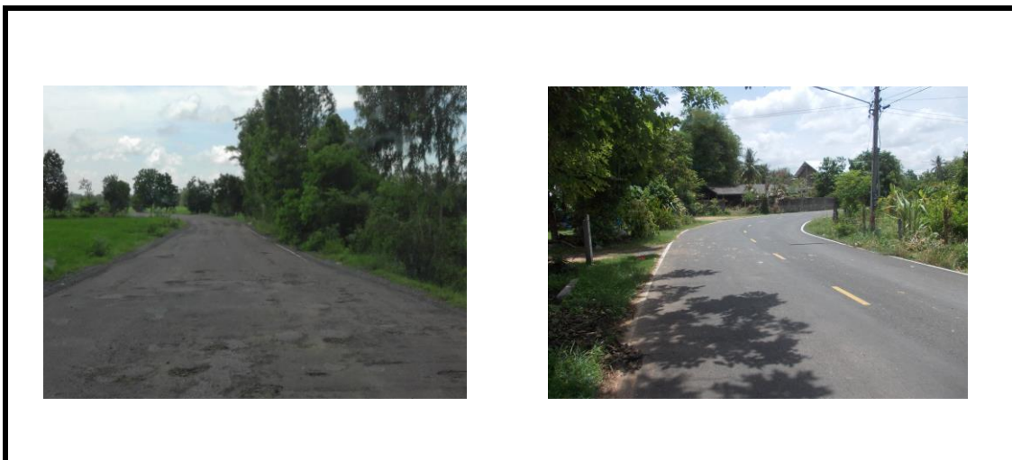
ภาพที่ 3-19 ถนนไม่มีหลักนำโค้งและ Grad rail
