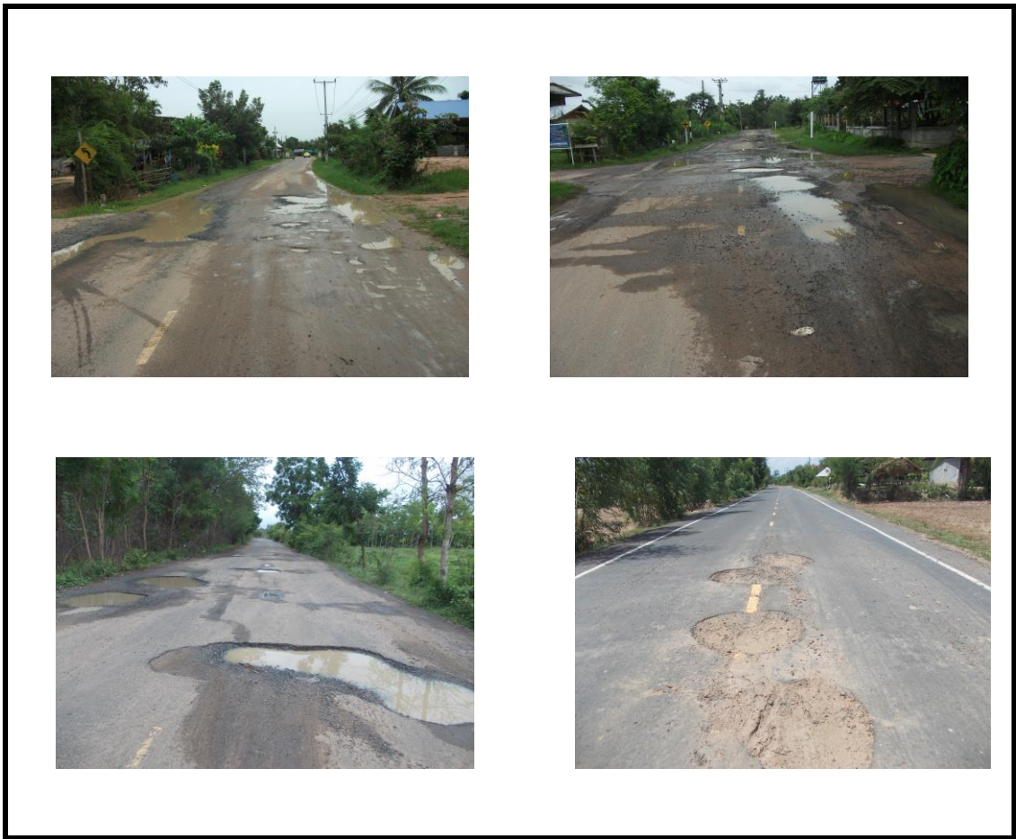
ภาพที่ 3-18 ถนนชำรุด-เป็นหลุมเป็นบ่อ
