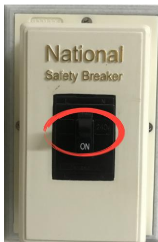
ภาพที่ ๔ ภาพแสดงการยกเบรกเกอร์ไฟฟ้าชุดเครื่องเสียงและโปรเจคเตอร์
