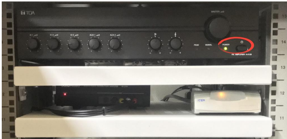
ภาพที่ ๕ ภาพแสดงการเปิดเครื่องเสียงโดยกดปุ่ม Power
