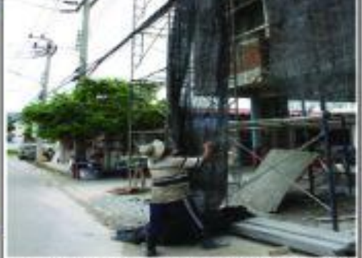
อาคารพาณิชย์ที่กำลังก่อสร้างบนพื้นที่จำกัดผิดมาตรฐาน พ.ร.บ.
