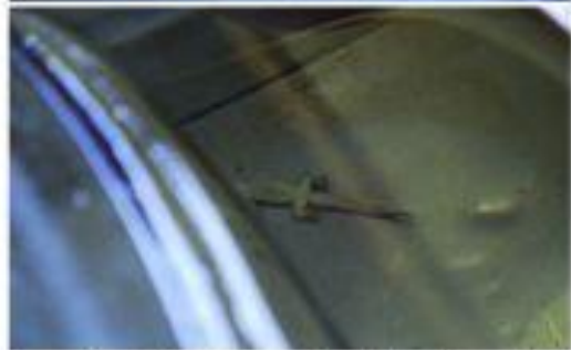
สภาพเครื่องทำน้ำเย็นได้คณะมนุษยฯ หน้าห้องนำหญิง ชั้น ๑ พบน้ำมีตะใคร้ สนิมเกาะ และจึงจกตาอยู่ในตู้น้ำ
