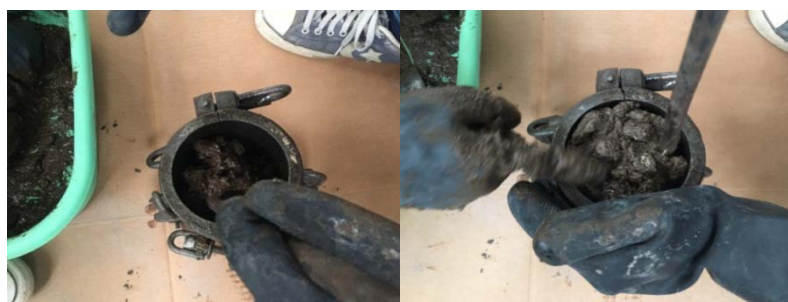
จ. เทจีโอพอลิเมอร์คอนกรีตในแบบหล่อแบ่ง 3 ชั้น ชั้นละเท่าๆกัน กระทุ้งชั้นละ 25 ครั้ง
