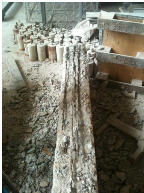
รูปที่ 4.8 คานที่ได้ทำการสกัดผิวคอนกรีตจึงถึงเหล็กกลาง
