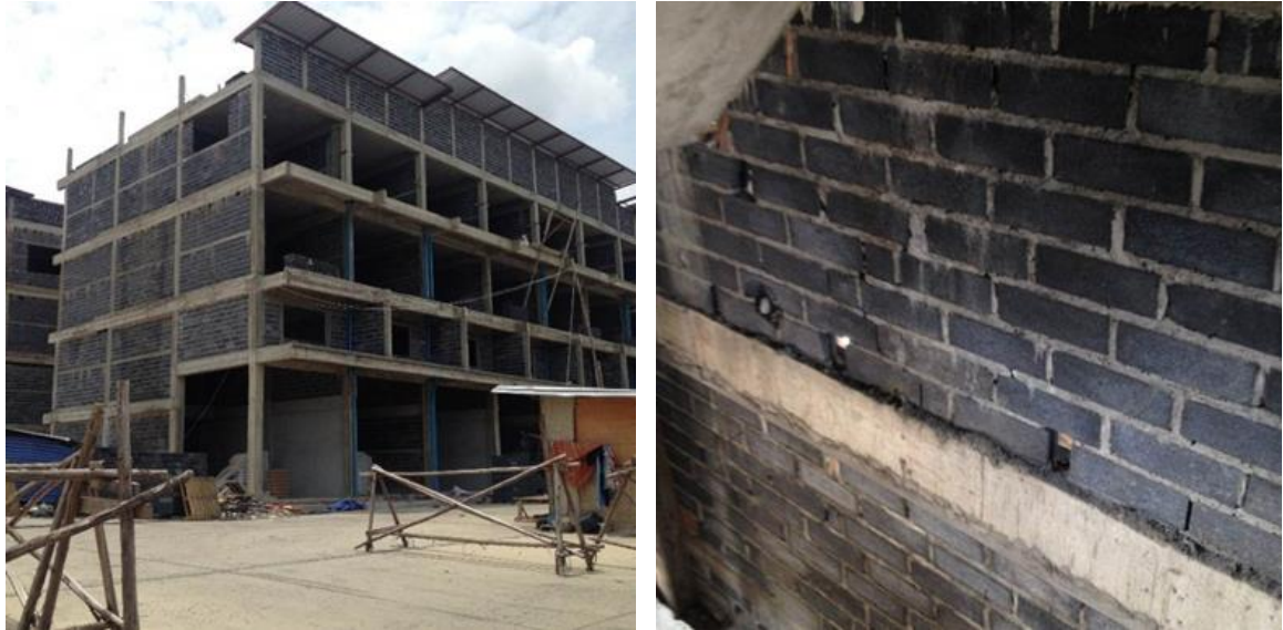
รูปที่ 2.3-3 อาคารที่ใช้อิฐบล็อกในการก่อสร้างผนัง (ลีลาทวีวัฒน์ และคณะ 2561)
