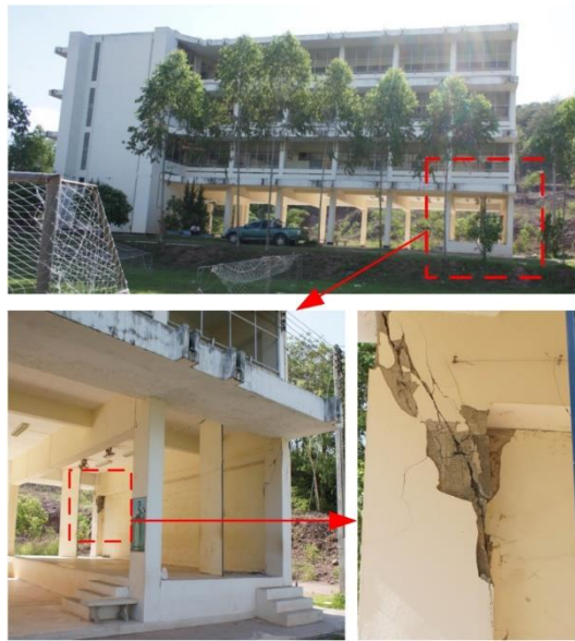
รูปที่ 1.1-1 การวิบัติด้วยแรงเฉือนของจุดต่อเสากับคานเนื่องจากแผ่นดินไหว
