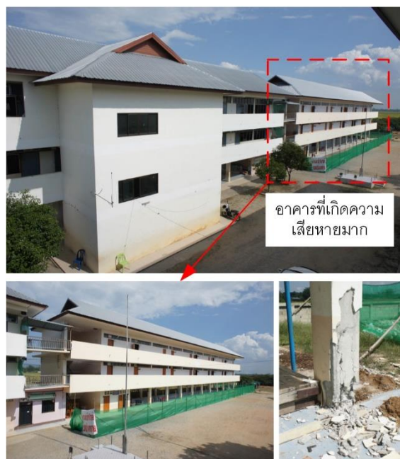
รูปที่ 1.1-2 ความเสียหายของอาคารเรียนเนื่องจากแผ่นดินไหว
