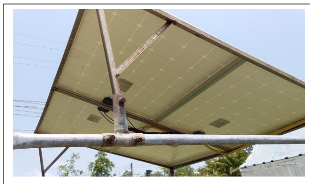
ภาพที่ 14 โซลาร์เซลล์สำหรับจ่ายพลังงานไฟฟ้าให้แก่สถานีตรวจวัดสภาพอากาศภายในแปลงทดลอง
