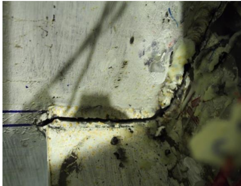
รูปที่ 4.9 ภาพถ่ายการฉีกขาดบริเวณปีกคานด้านล่าง RBS1
