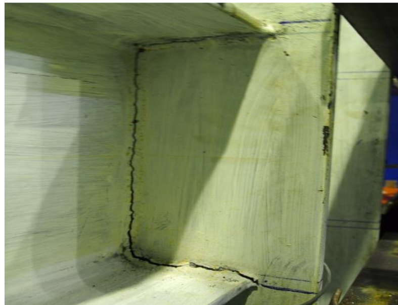
รูปที่ 4.8 การฉีกขาดที่รอยเชื่อมบริเวณแผ่นเอวคาน RBS1
