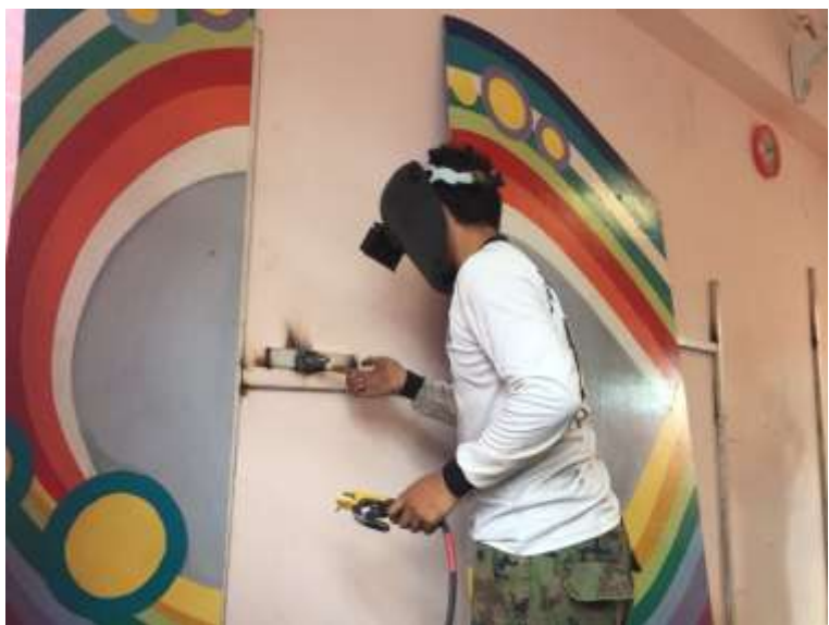
ภาพที่ 4-179 ติดตั้งผลงานประกอบ โครงสร้าง
