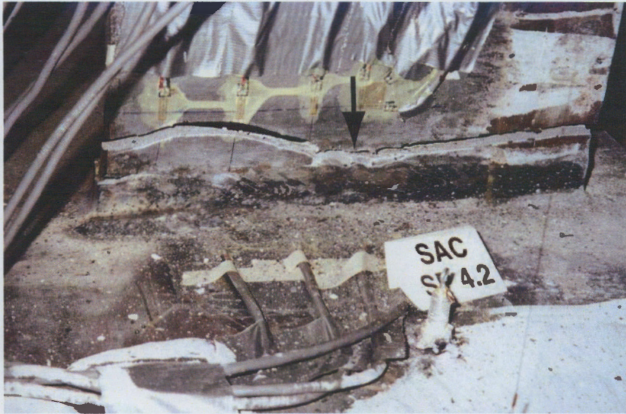
รูปที่ 4.8 แสดงลักษณะการแตกของปีกคานด้านผิวบน ที่บริเวณ Access Hole ของชิ้นงานทดสอบ
