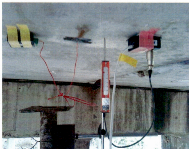
รูปที่ 3.4 ลักษณะการติดตั้งอุปกรณ์ตรวจวัดค่าการแอ่นตัว
