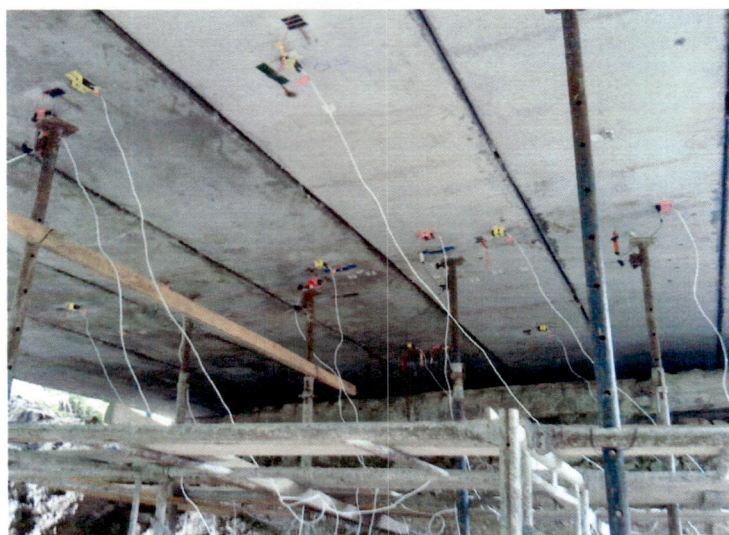
รูปที่ 3.6 ลักษณะการติดตั้งอุปกรณ์ตรวจวัดต่างๆ ใต้พื้นสะพาน
