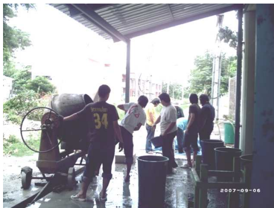
รูปที่ 3.35 การผสมคอนกรีตที่ใช้ในการหล่อคานตัวอย่างทดลอง
