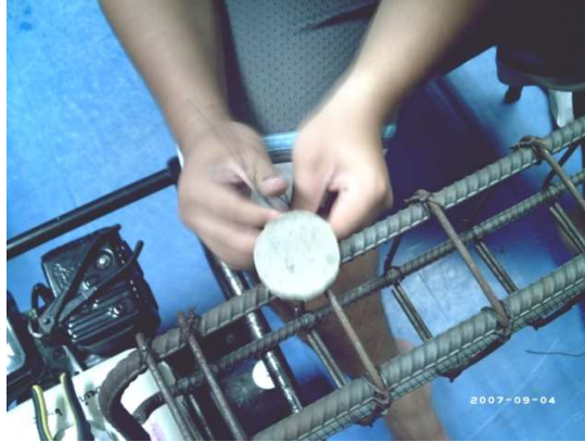
รูปที่ 3.28 การติดลูกปูนเพื่อให้ได้ระยะหุ้มเหล็กเสริมที่ต้องการ
