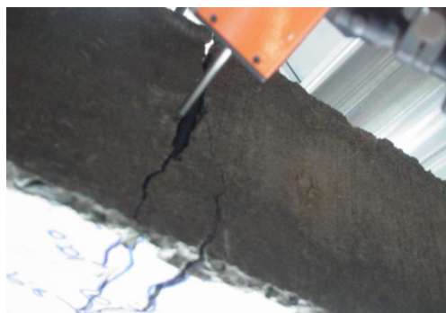
รูปที่ 5.26 ลักษณะรอยร้าวของคานคอนกรีตเสริมเหล็ก B01
