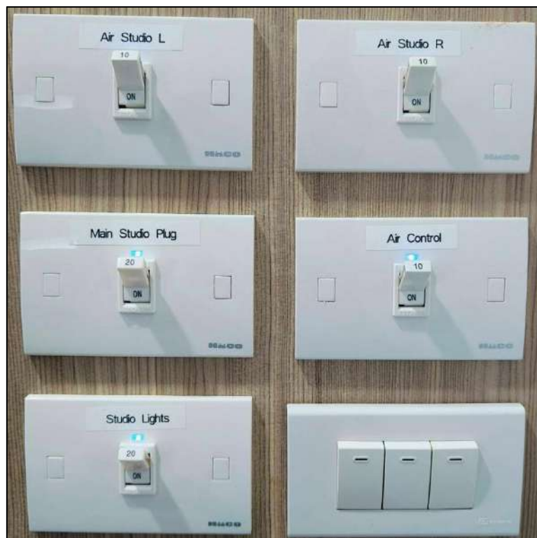
ภาพที่ 15 สวิตช์ควบคุมภายในห้องสตูดิโอ (ที่มา: บันทึกภาพโดยผู้เขียน)
