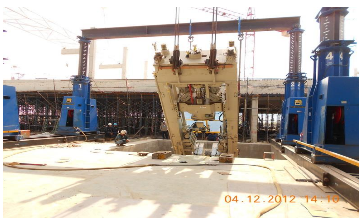
ภาพที่ 2-3 Installation งานติดตั้งเครื่องจักร
