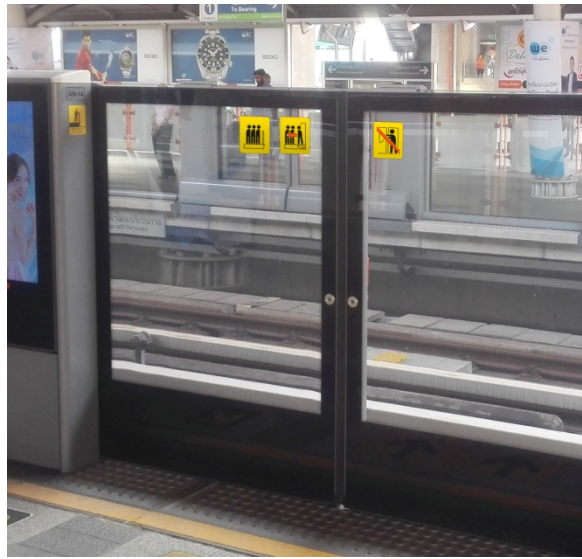
ภาพที่ 4-32 ตำแหน่งติดตั้งป้ายสัญลักษณ์บริเวณประตูอัตโนมัติของชานชาลา
