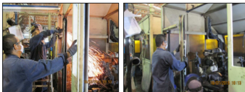
ภาพที่ 4-7 การตัดเหล็กโครงสร้างด้านหน้าซุ้ม 로봇
