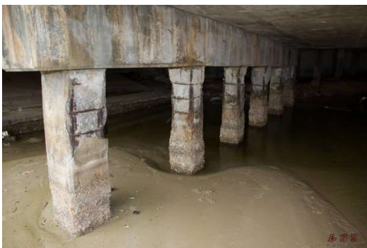
ก. สภาพของเสาตอม่อสะพานที่เผชิญสิ่งแวดล้อมทะเล และเกิดการเสื่อมสภาพจากสนิมเหล็กเสริมจนค้ำให้คอนกรีตแตกและหลุดร่อน
