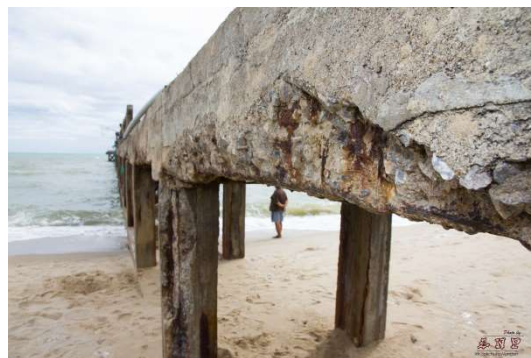
ข. สภาพของเสาและคานสะพานที่เผชิญสิ่งแวดล้อมทะเล และเกิดการเสื่อมสภาพจากสนิมเหล็กเสริมจนค้ำให้คอนกรีตแตกและหลุดร่อน
