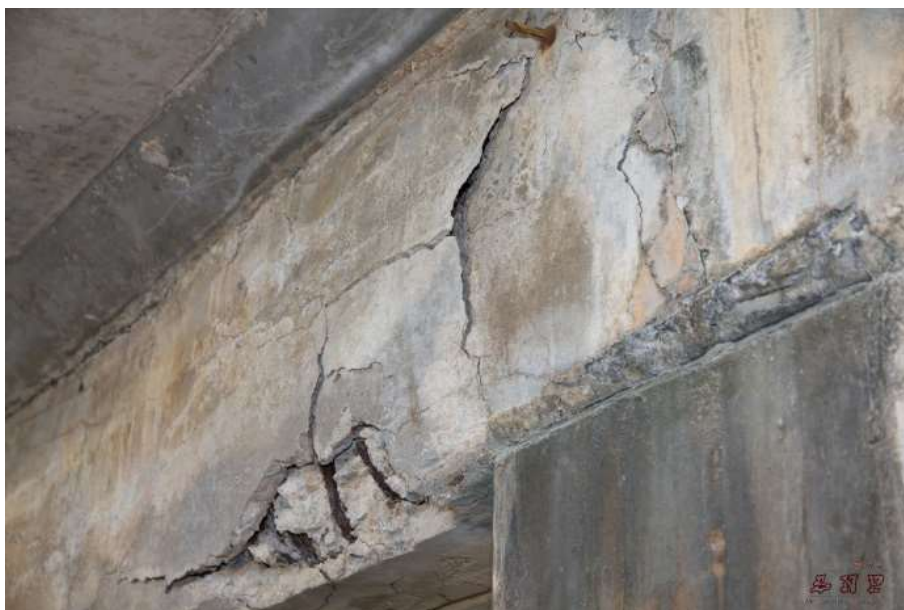
ภาพที่ 2-7 การเกิดการขยายตัวปริมาตรเหล็กเสริมทำให้เกิดรอยแตก และการหลุดร่อนของเนื้อคอนกรีต
