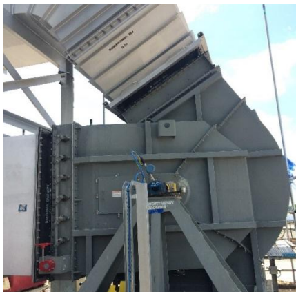
ภาพที่ 2-18 ตัวอย่างพัดลมเป่าอากาศ บริษัท ไทยออยล์ จำกัด (มหาชน)
