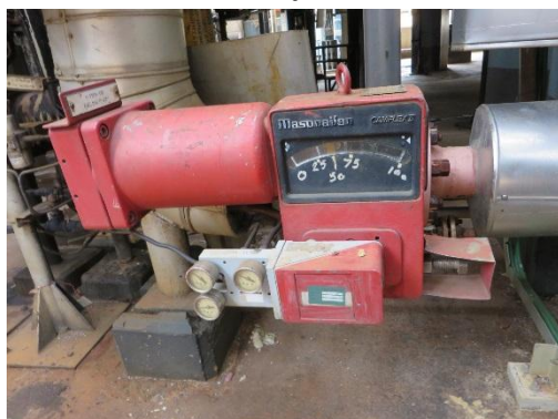
(ง) อุปกรณ์ควบคุมอัตราการไหล
