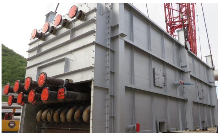
ภาพที่ 2-9 ตัวอย่างโครงสร้าง Convection bank ณ บริษัท ไทยออยล์ จำกัด (มหาชน)
