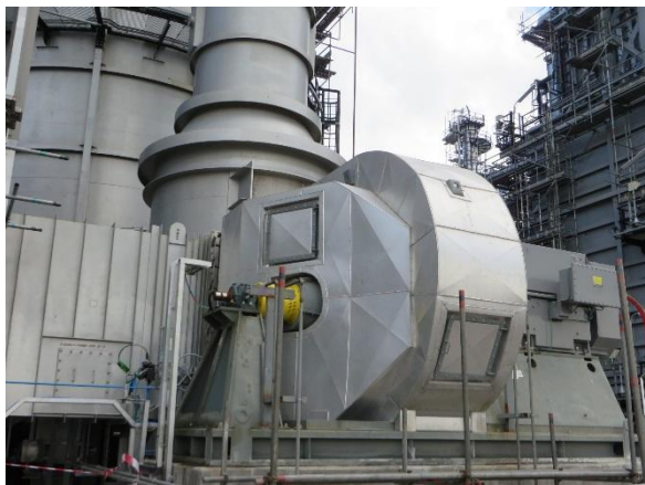
ภาพที่ 2-19 ตัวอย่างพัดลมดูดก๊าซไอเสีย บริษัท ไทยออยล์ จำกัด (มหาชน)
