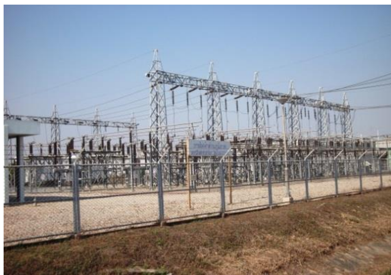
ภาพที่ 1-5 สถานีไฟฟ้าย่อย
