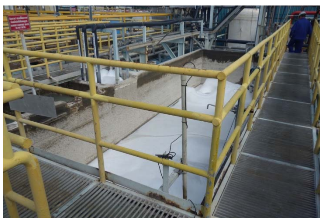
ภาพภาคผนวกที่ ค-2 ถังปรับเสมอของ บริษัท บีเอสเอฟ (ไทย) จำกัด
