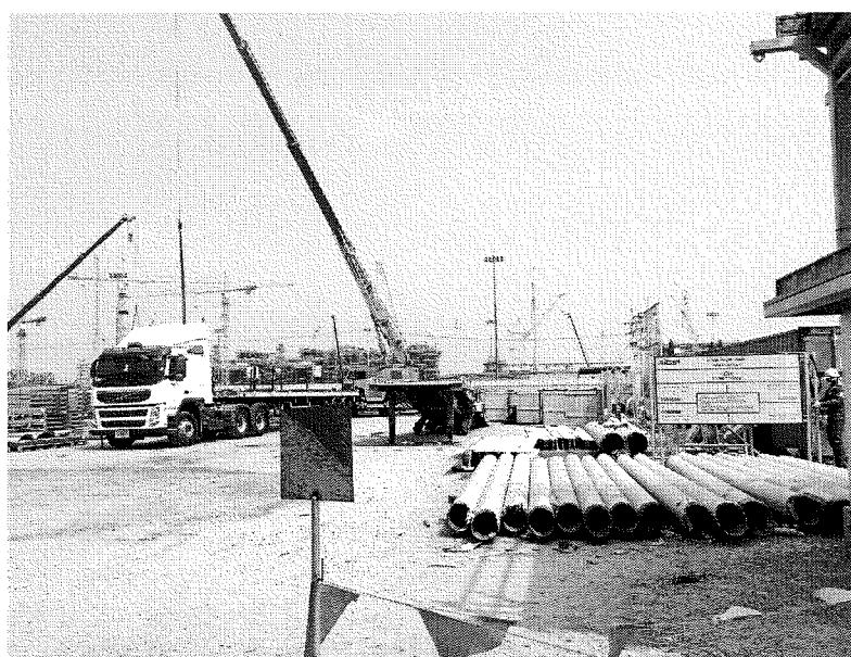
ภาพที่ 4-3 พื้นที่ในการเก็บสินค้า Fabrication
